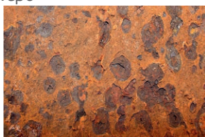
Διάβρωση στο χώρο του λεβητοστασίου
