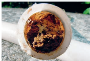
Ρύπανση σωλήνα θέρμανσης
